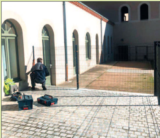
Espace loisirs square Arnaud de Mareuil : Terrassement avant de couler la dalle pour installer le jeu d'enfants - Pose de la clôture
